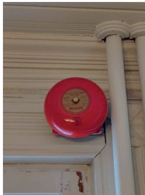
Figure 41 : Cloche d'alarme incendie
