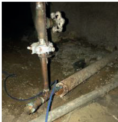
Figure : Dispositif d'appoint d'eau non conforme (à remplacer)
