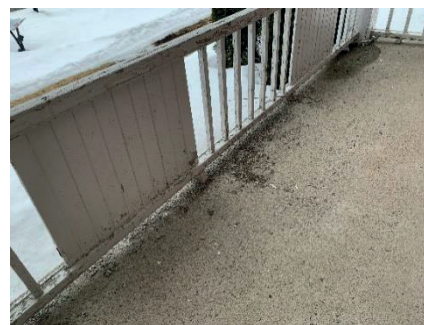
Perron- Dalle de béton écaillée
