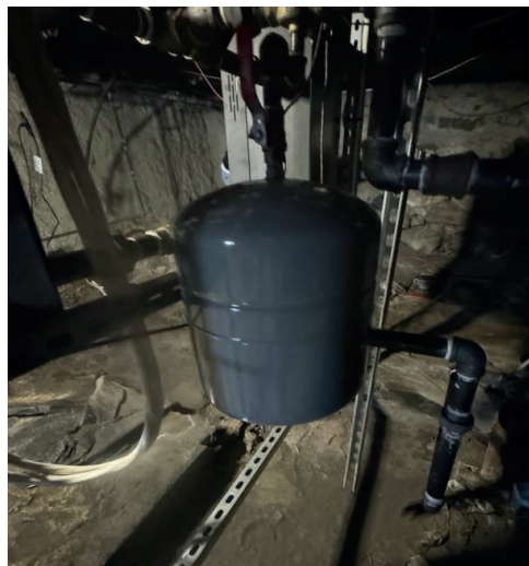
Figure : Réservoir d'expansion du réseau d'eau de chauffage (à enlever)
