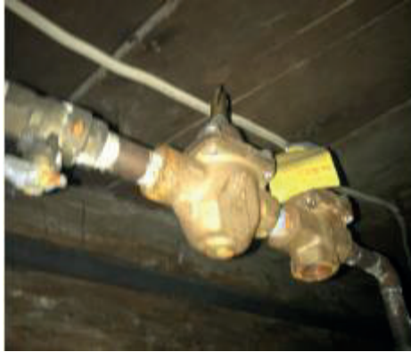
Figure : Dispositif d'appoint d'eau de chauffage
