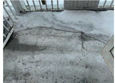
Marquise – Dégradation balustrade
