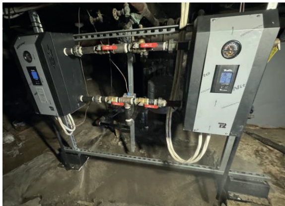
Figure : Chaudière électrique en bon état (à enlever)
