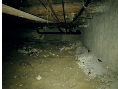
Figure : Tuyauteries de drainage (à remplacer)
