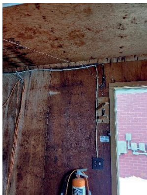
Figure 35 : Filage en surface non protégé mécaniquement
