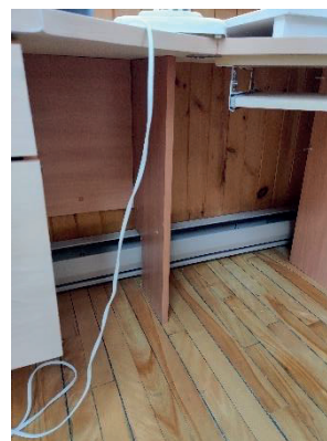
Figure 38 : Plinthe chauffante existante
