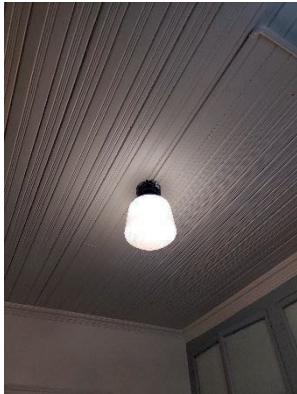
Figure 39 : Luminaires surface avec conduit surface
