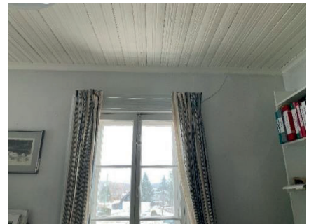
Étage – Fissure local 207
