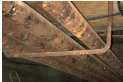
Figure : Tuyauterie de chauffage oxydé (à remplacer)
