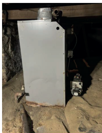
Figure : Chaudière au mazout non fonctionnelle (à démanteler et à évacuer)
