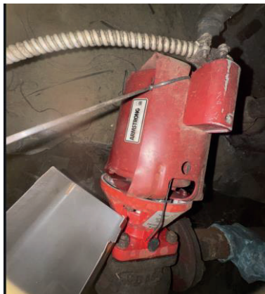
Figure : Pompe de chauffage principale (à démanteler)
