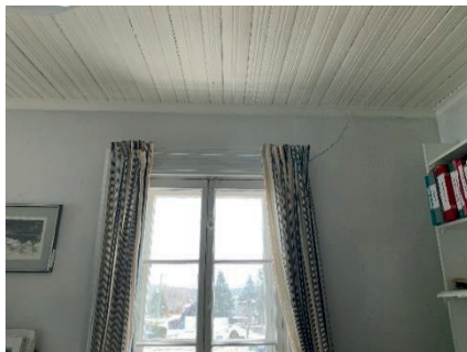
Étage – Fissure local 207
