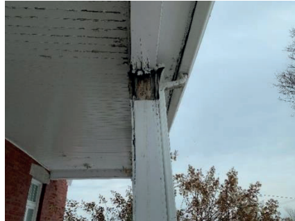
Marquise – Dégradation colonne de bois
