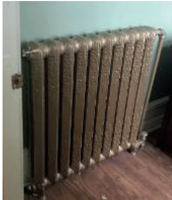
Figure : Radiateur en fonte (à remplacer)
