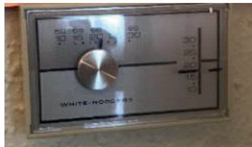
Figure : Thermostat désuet (à remplacer)
