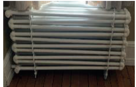
Figure : Radiateur en acier noir (à remplacer)
