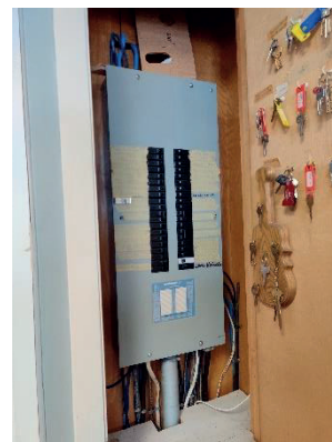
Figure 30: Panneau électrique 120-240V désuet et pleine capacité
