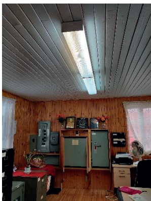
Figure 29: Sectionneurs, auget, panneau électrique, mesurage
