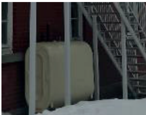
Figure : Réservoir d'huile extérieur (à relocaliser)
